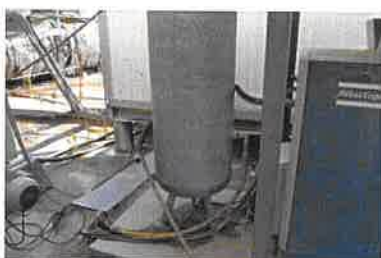
Rezervor aer comprimat
