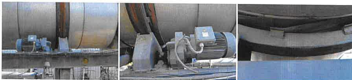
Inele de rulare si motoreductoare de antrenare tambur
