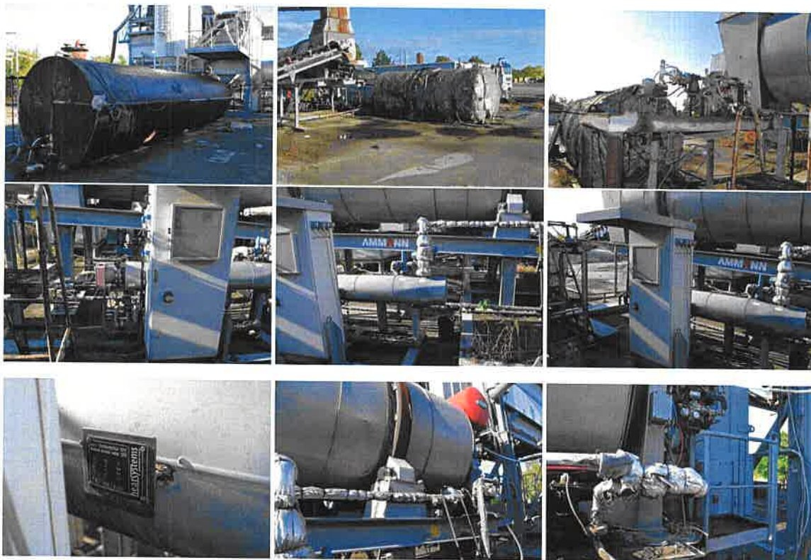
Rezervoare, pompe si sistem incalzire combustibil
