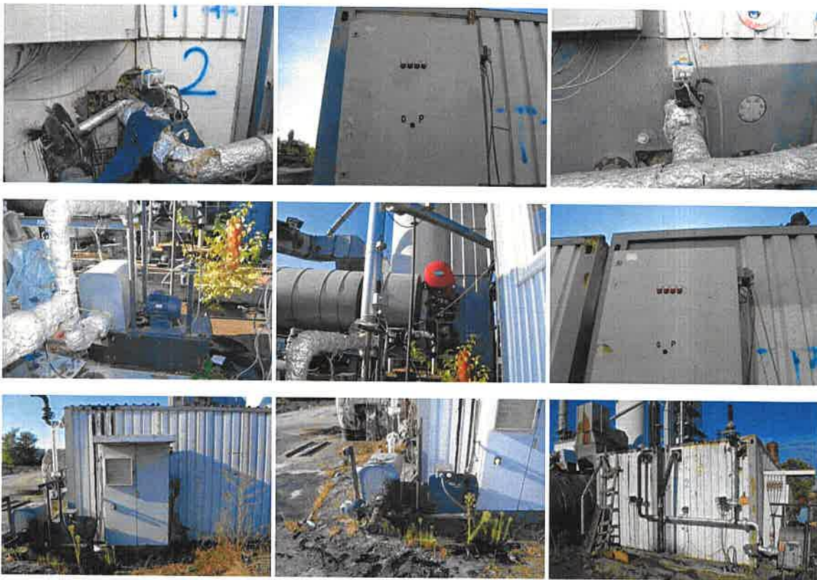
Sistem alimentare bitum: rezervoare, pompa descarcare si alimentare, conducte, tablouri electrice
