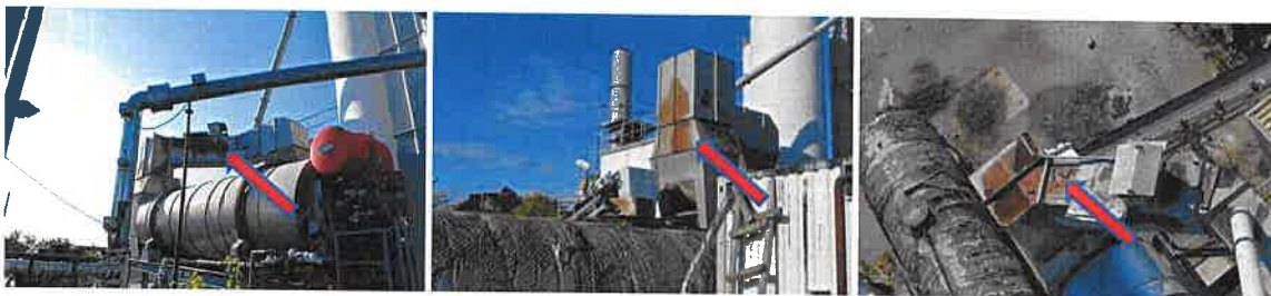
Elemente corodate ale tubulaturii de absorbtie
